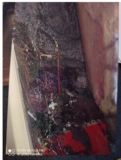
Figura 4: Fundos do prédio tomados por terra, lixo, pedaços de encosta, plantas e outros objetos, 24 out. 2005. Fonte: Acervo do autor.
